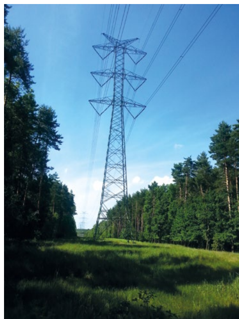
Linia 400 kV, w lesie w Leboszowicach
